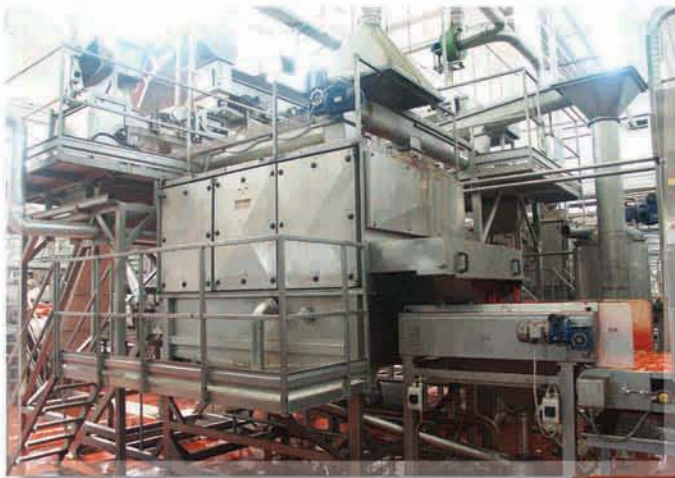
Gruppo di cubettatura con preriscaldamento del cubetto
